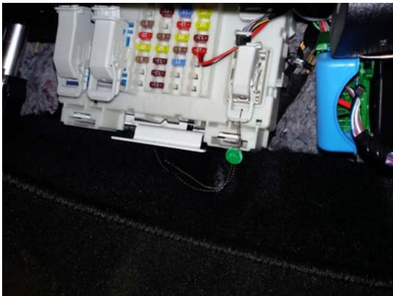
Toma de señal
